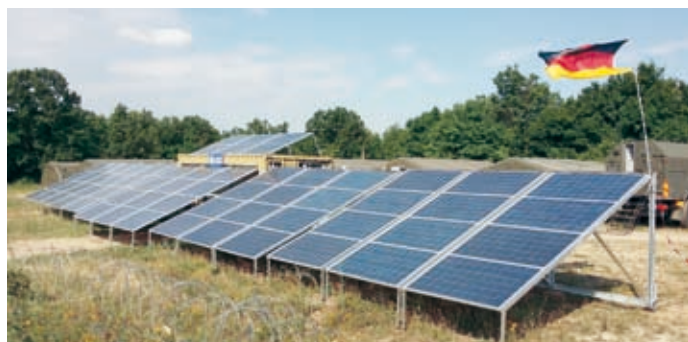
Solarcontainer Strom von Multicon Solar für die Military Police. © Multicon Solar
